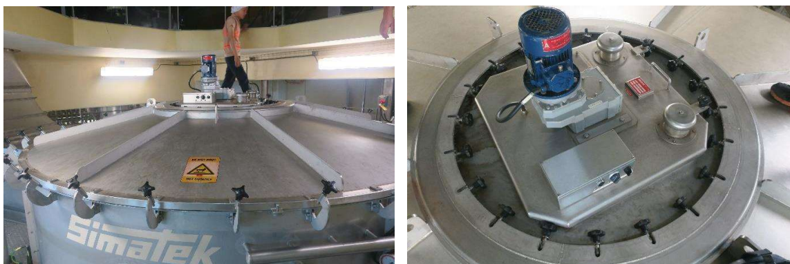
Hình 3.32: Hệ thống xử lý khí thải tháp sấy bột cà phê
