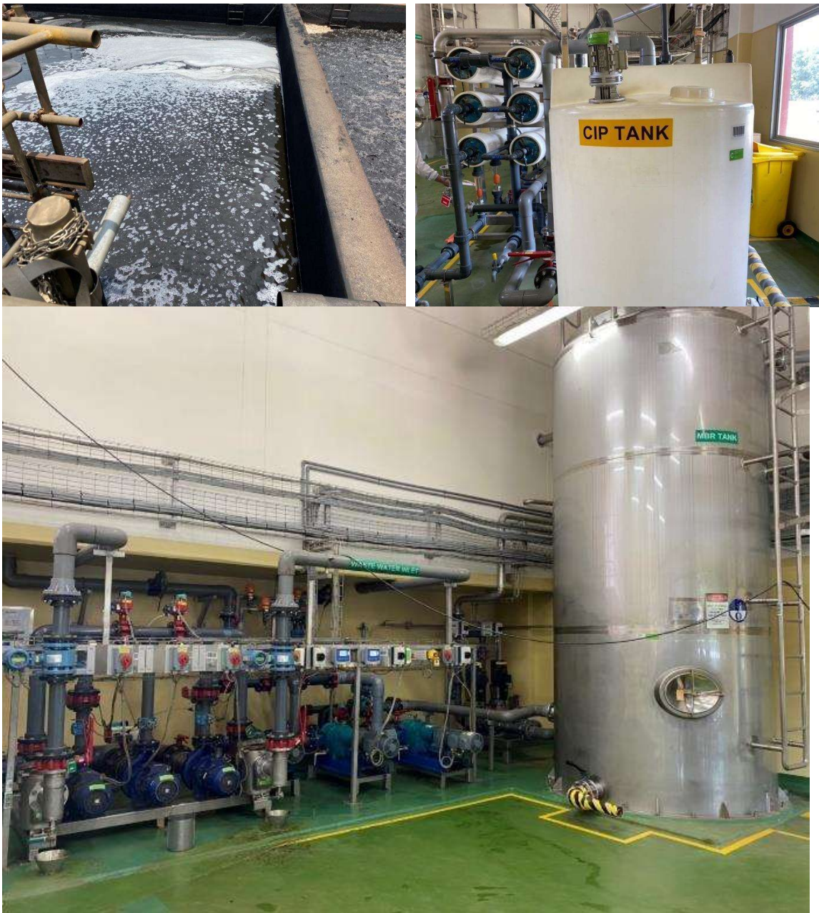
Hình 3.12: Hệ thống xử lý nước thải sản xuất công suất 1.100 m 3 /ngày
