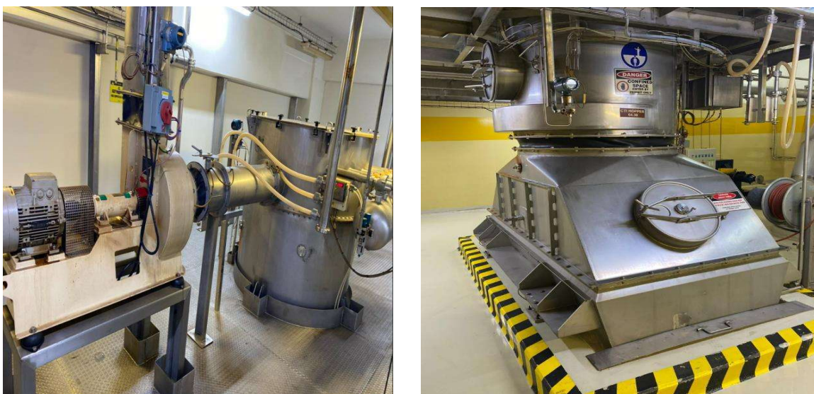
Hình 3.16: Hệ thống xử lý khí thải tháp sấy bột cà phê
