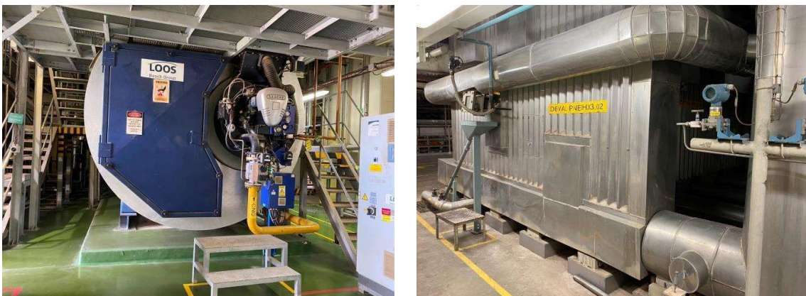
Hình 3.14: Hệ thống xử lý khí thải lò hơi tầng sôi
