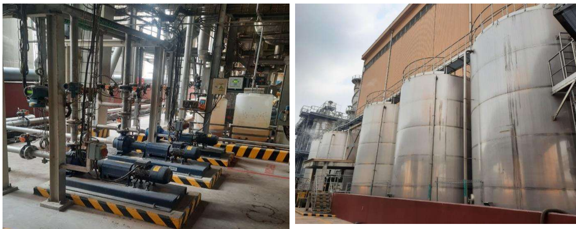
Hình 3.10: Hệ thống xử lý nước thải sản xuất có độ màu cao công suất 456 m 3 /ngày
