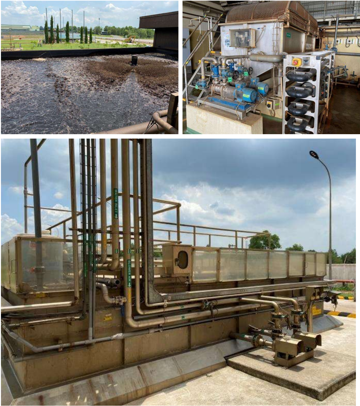
Hình 3.8: Hệ thống xử lý nước thải sản xuất công suất 700 m 3 /ngày
