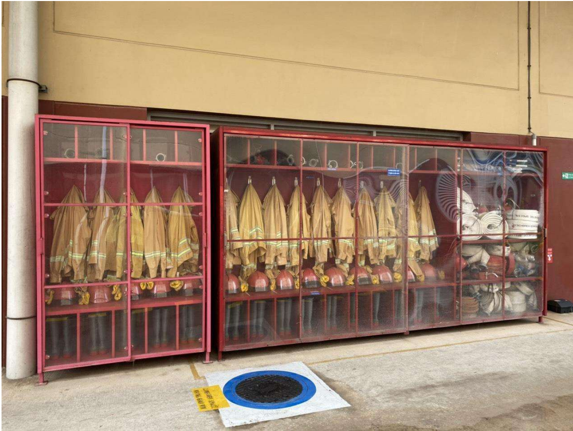
Hình 3.38: Hình ảnh trang thiết bị PCCC
