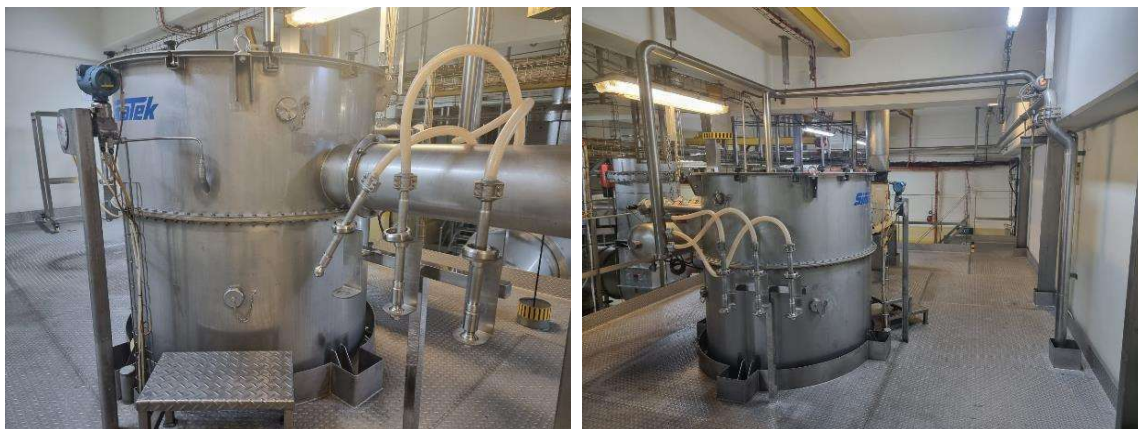
Hình 3.30: Hệ thống xử lý khí thải tháp sấy bột cà phê
