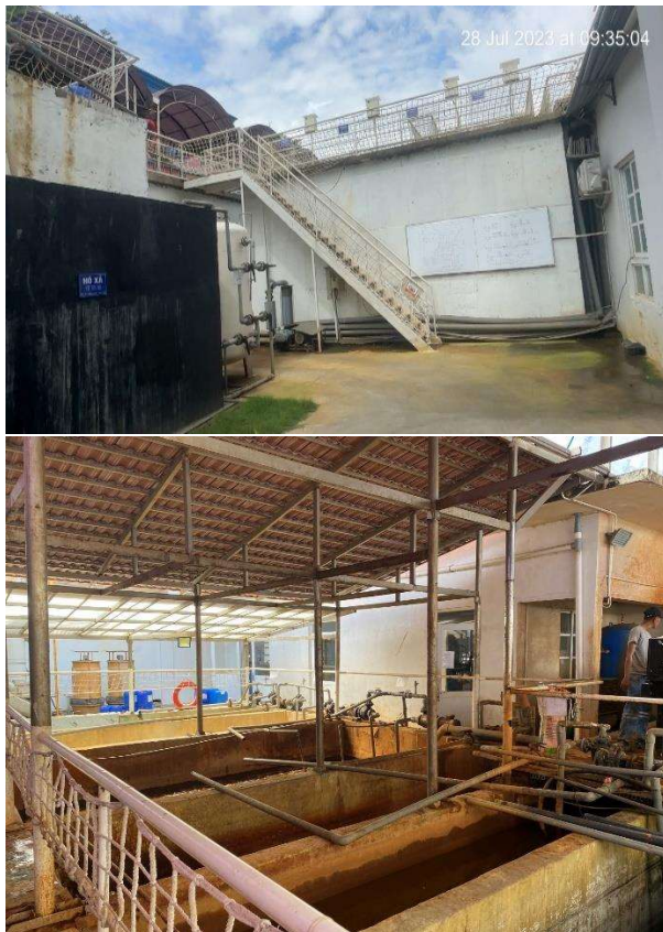
Hình ảnh hệ thống xử lý nước thải
