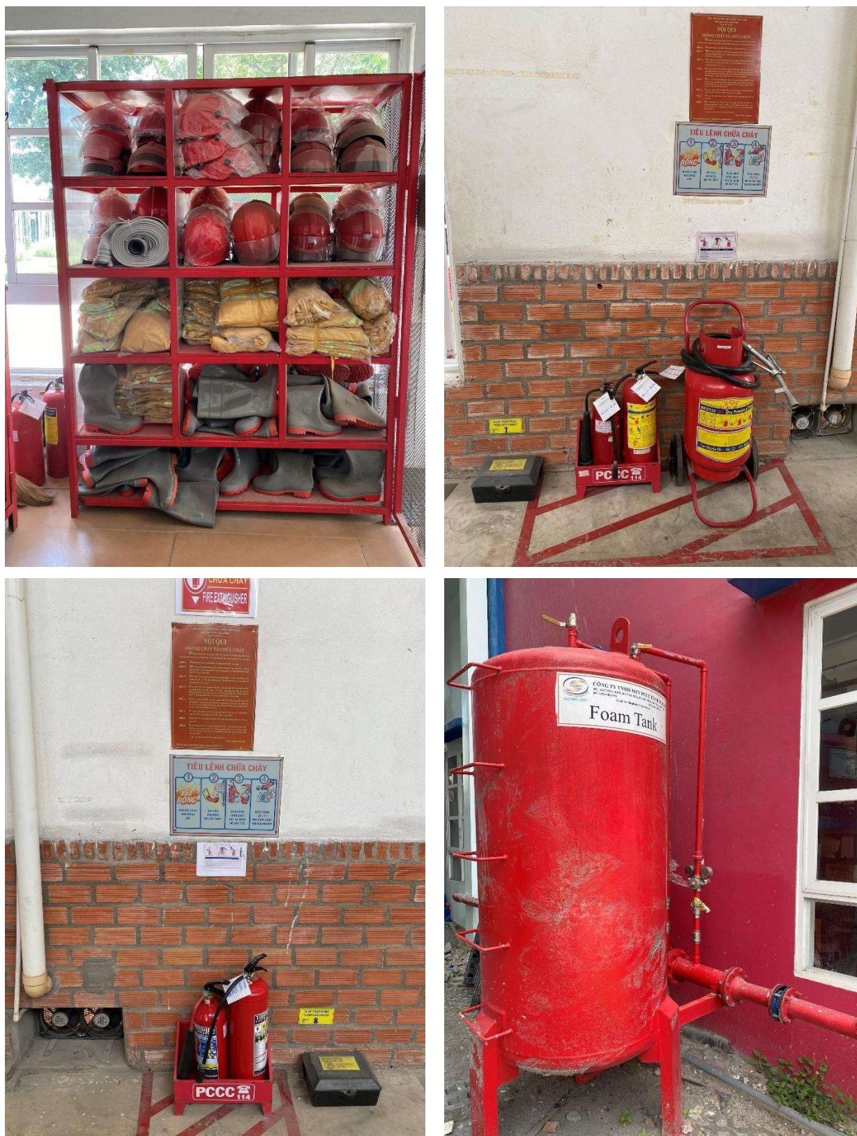
Hình 3.28: Hình ảnh trang thiết bị PCCC
