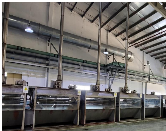
Máy giặt (bồn nước nóng)
