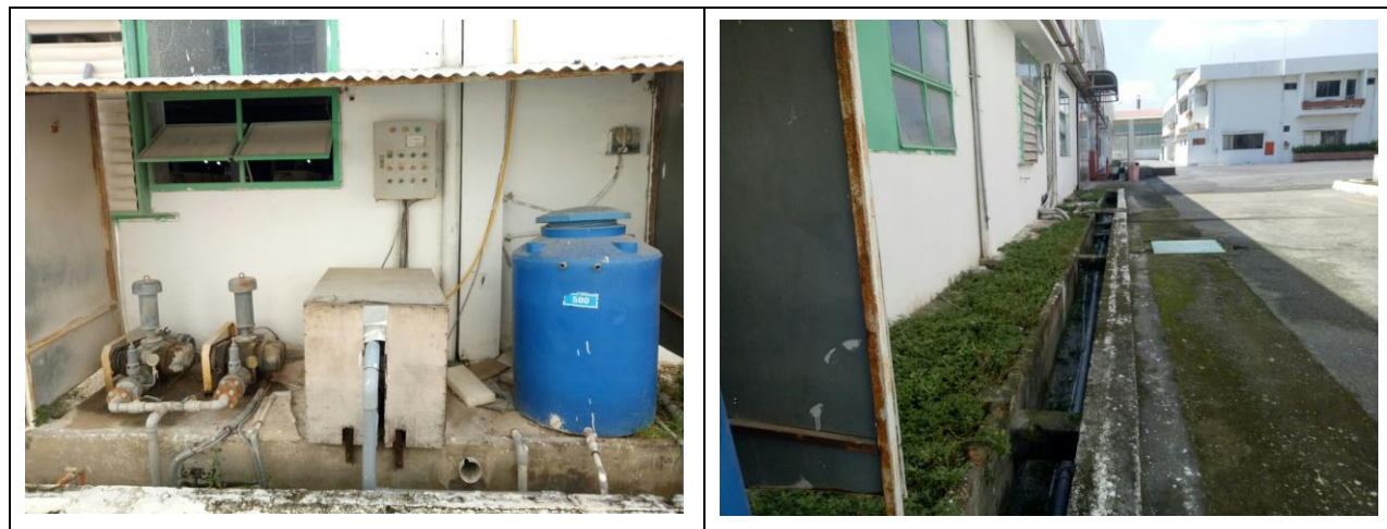
Hình 3.4. Hình ảnh hệ thống xử lý nước thải sinh hoạt, công suất 140 m 3 /ngày.đêm
