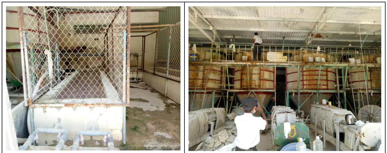
Hình 3.6. Hình ảnh hệ thống xử lý nước thải sản xuất, công suất 180 m 3 /ngày.đêm
