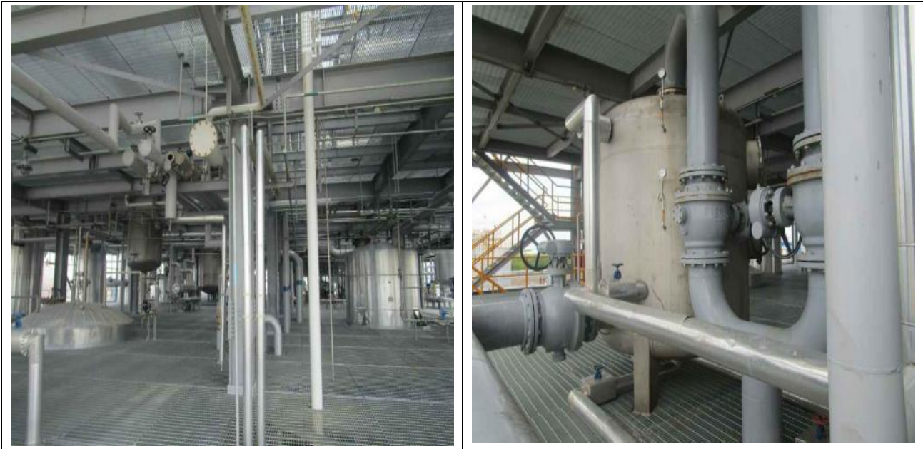
Hình 4.17: Một số hình ảnh thiết bị tại HTXLKT sản xuất tại nhà máy
