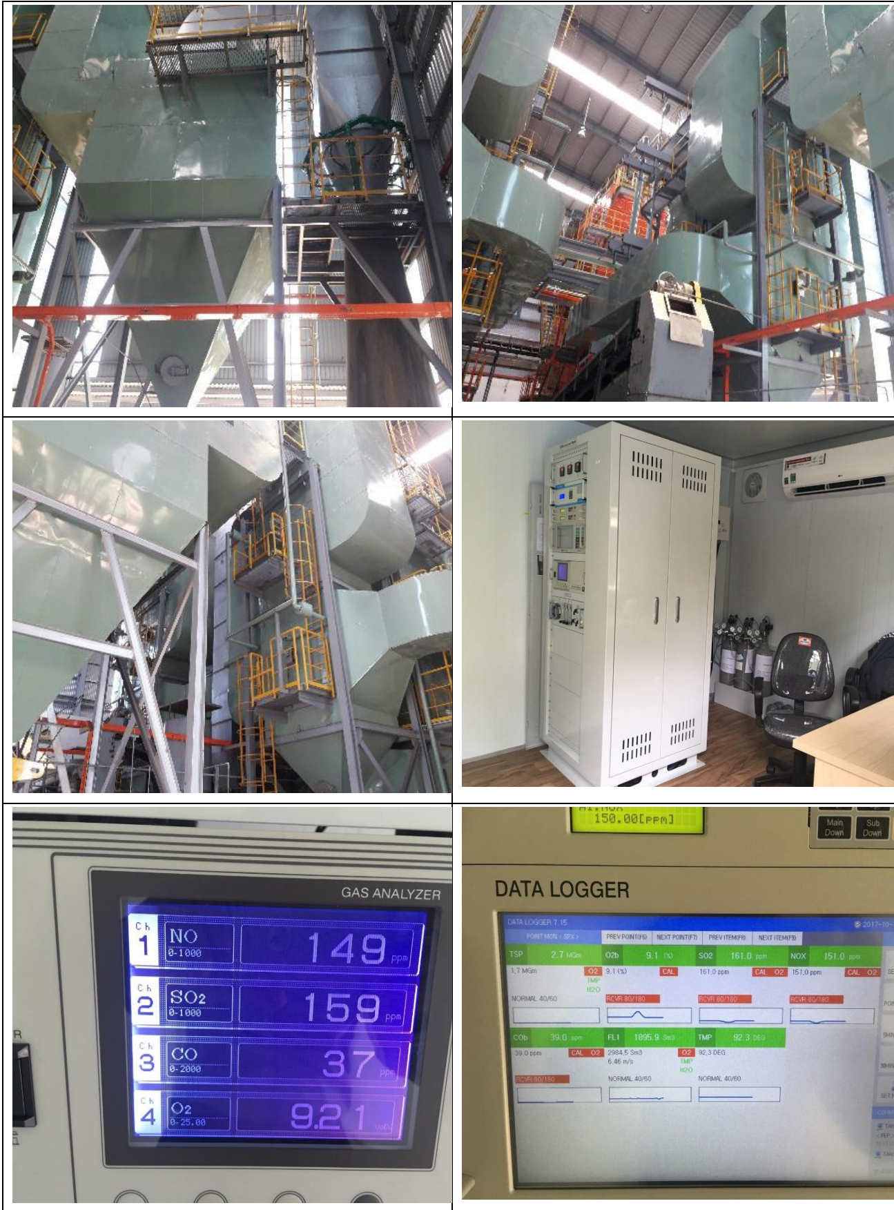
Một số hình ảnh tại khu vực lò hơi và thiết bị quan trắc khí thải tự động của nhà máy PTMG
