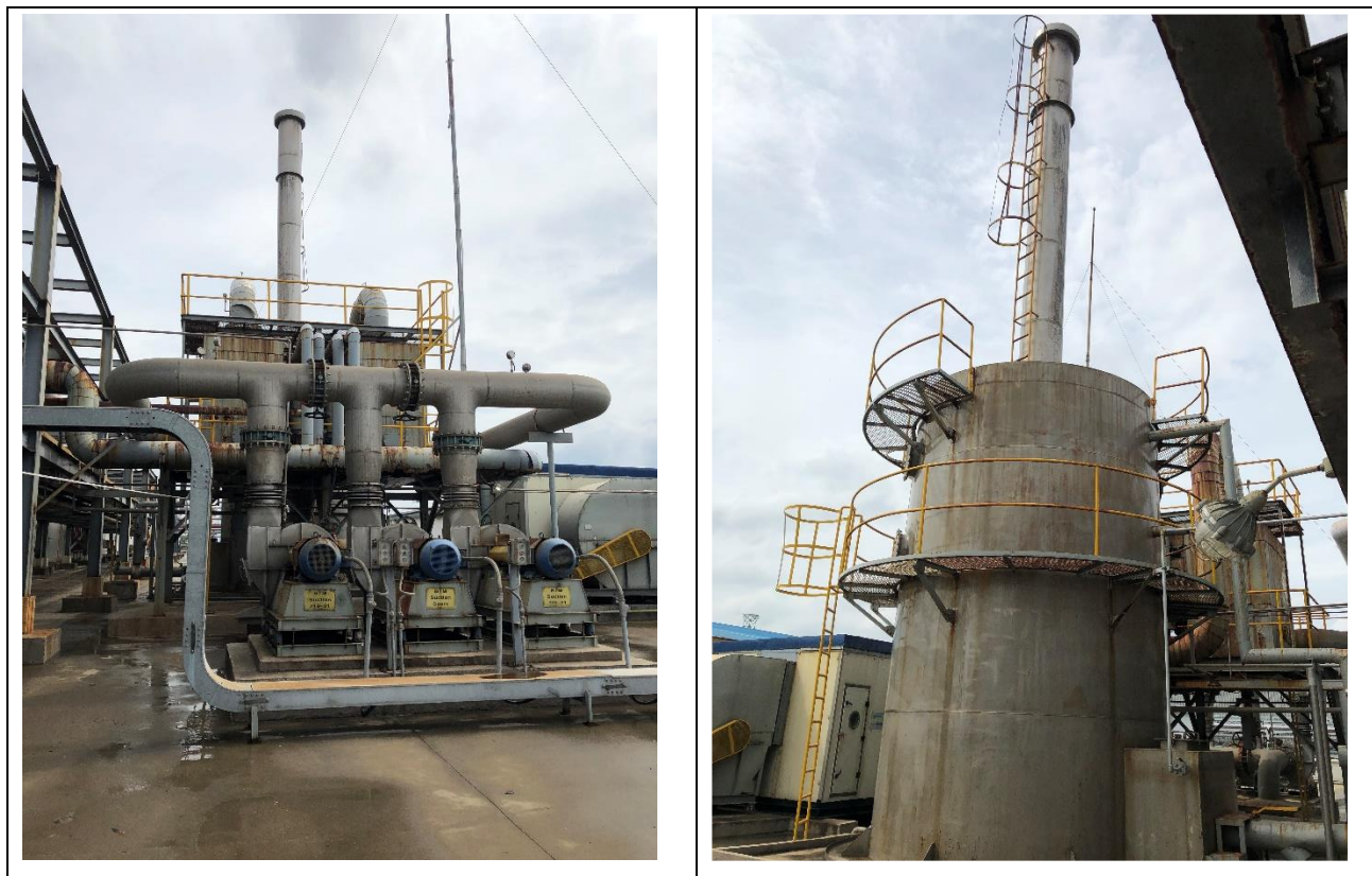
Hình 4.27: Hình ảnh các hệ thống xử lý hơi hóa chất nhà máy spandex
