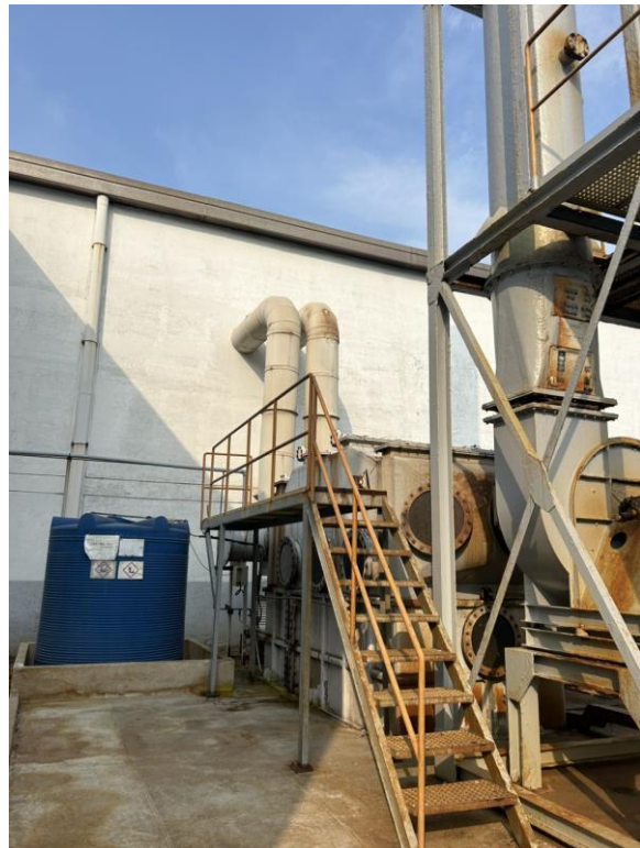
HTXL hơi hóa chất chung sợi viên 2, công suất 18.000 m 3 /h
