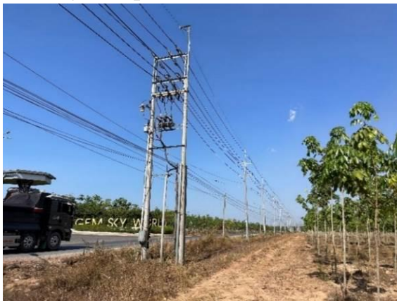
Tuyến điện 22kV dọc đường Long Đức-Lộc An
