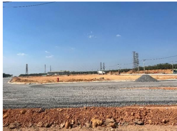
Tuyến điện 220 kV tại ranh giới phía Bắc
